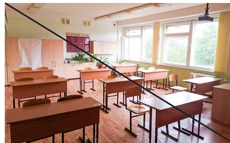
Плохо Линолеум под дерево
